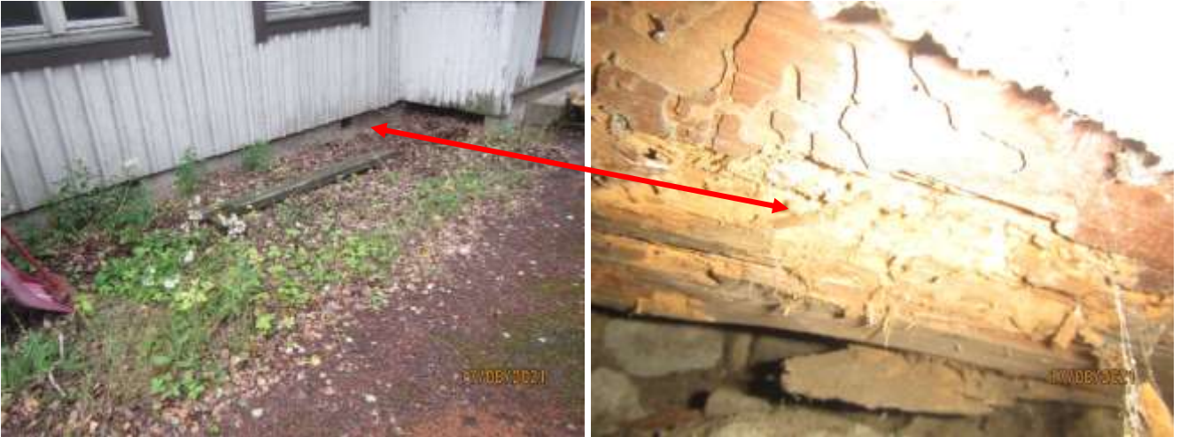
Kuvat 9-10. Talon luoteispuoli.
