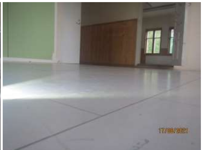
Kuva 36. Lattian painumisen huomaa.
