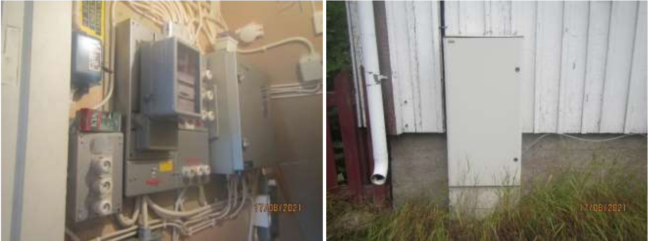
Kuvat 31-32. Sähkökeskus sisällä ..... sekä pääsähkökeskus ulkona seinällä.
