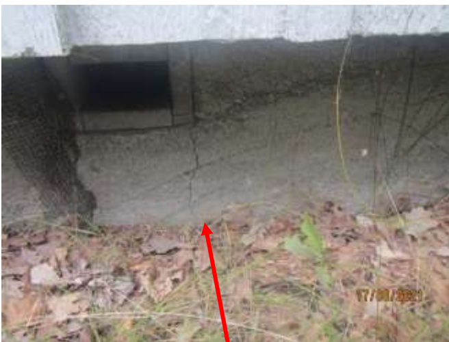
Kuvat 1-2. Sokkelissa on joitakin halkeamia.
