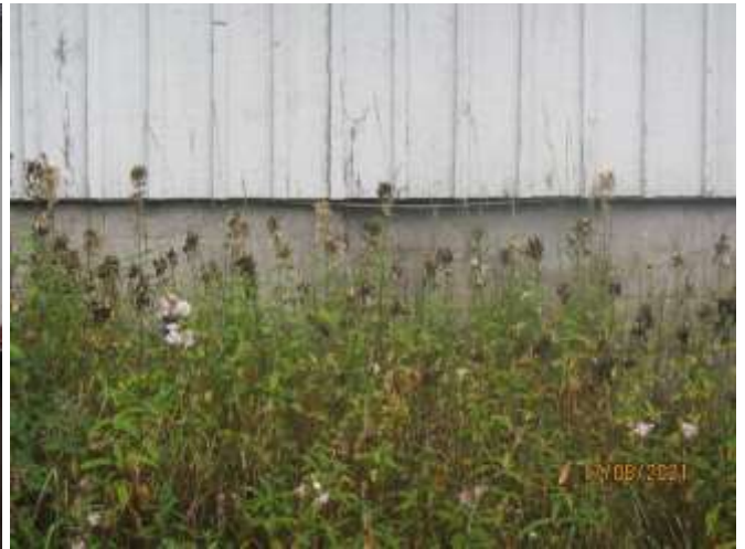
Puuverhous on paikoin kulunut.
