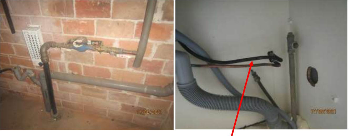
Kuvat 25-26. Yleiskuvia vesimittarista kellarissa ..... sekä käyttövesiputkista keittiössä.
