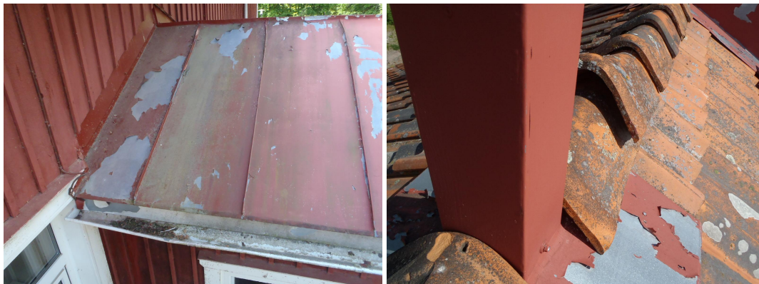
Kuvat 10 ja 11. Peltiosien maalipinta hilseilee voimakkaasti. Harjatiilet ovat paikoin huonosti paikoillaan.
