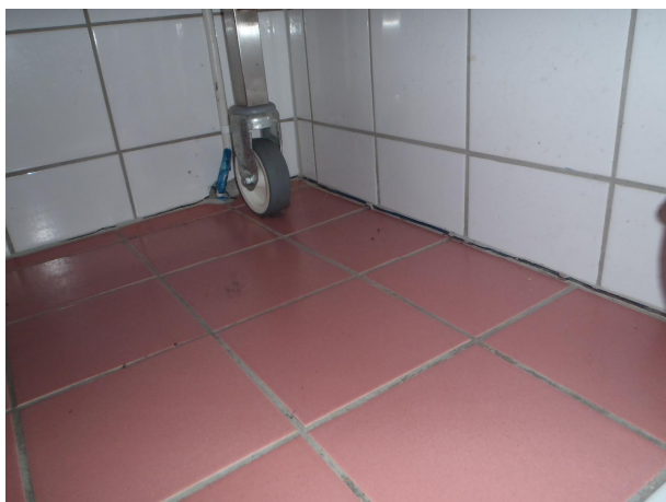
Kuvat 7. Keittiön lattia on painunut ulkoseinustalta vanhan osan puolelta.
