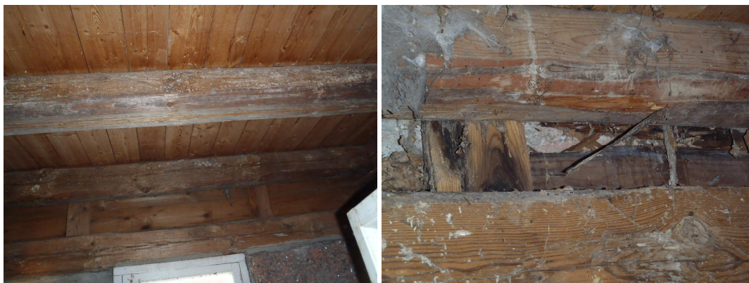
Kuva 4 ja 5. Ryömintätilan tuuletusluukut ovat pääosin tukittuja. Vasemmanpuoleisen sisäänkäynnin kohdalla alapohjassa havaittiin lahovaurioita.
