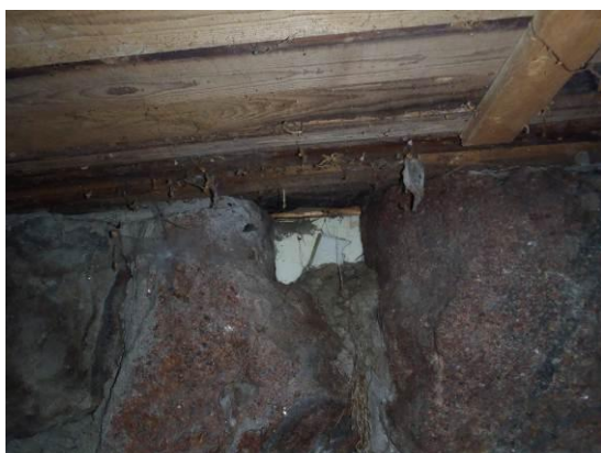
Kuva 3. Ryömintätilan tuuletusluukut ovat pääosin tukittuja.
