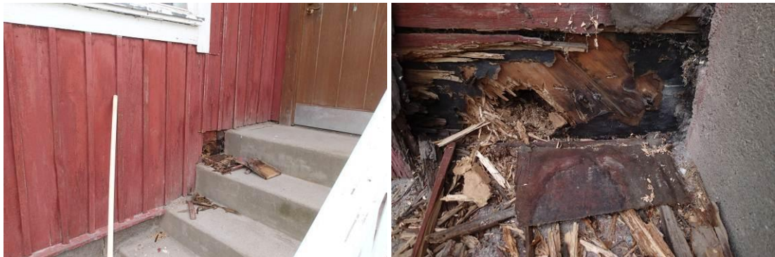
Kuvat 21 ja 22. Lounaispäädyn kuistin portaiden vierellä oli lahoa seinän alareunassa. Laho jatkui koko rakenteen läpi eristeeseen asti.
