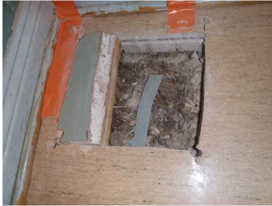
Kuva 16. Eteisen lattiassa oli lastulevykerroksen alla magnesiamaakerros (valko- vaaleanpuna-vihreä-kerros kuvassa).
