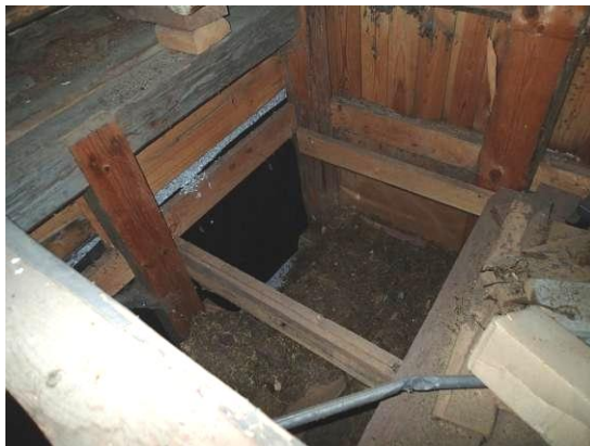
Kuva 27. Yläpohjasta puuttuu eristettä kaakkoissivulla ulkoseinän viereltä.
