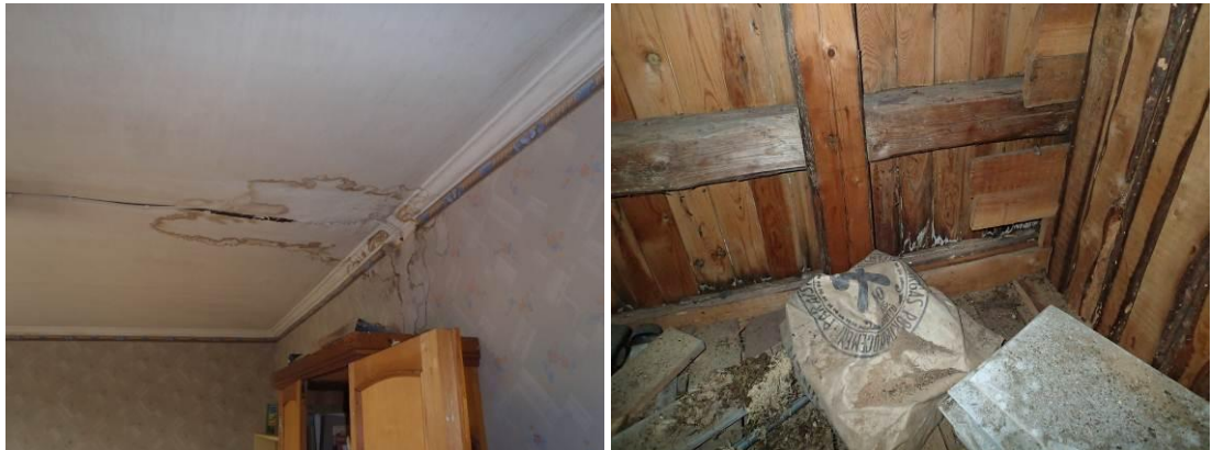
Kuvat 25 ja 26. Kosteusjälkiä havaittiin kesähuoneen katossa sekä yleisesti lounaispäädyn ulkoseinässä yläpohjan rajassa.
