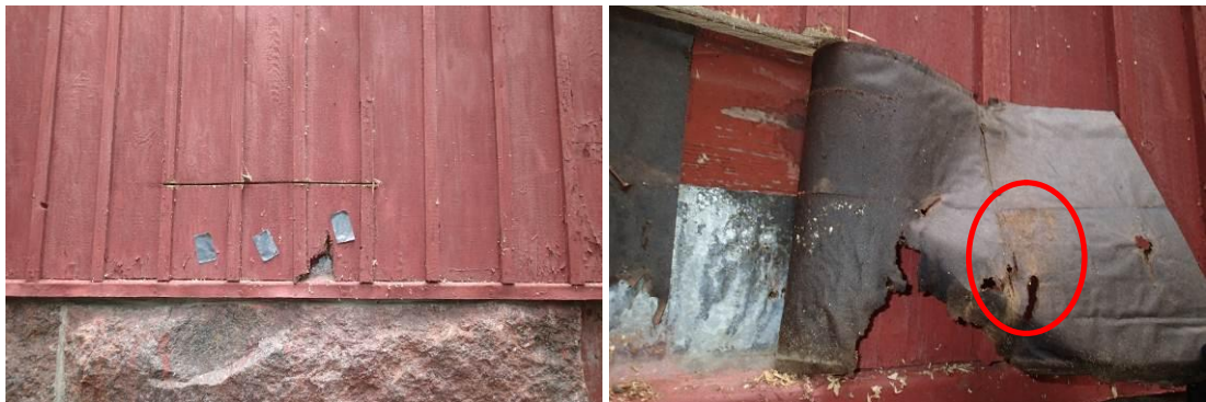
Kuvat 19 ja 20. Koillispäädyn avauskohdassa ulkoverhouksen alareunassa oli lahoa ja taustan tervapaperissa näkyvää rihmastoja (ympyrä).
