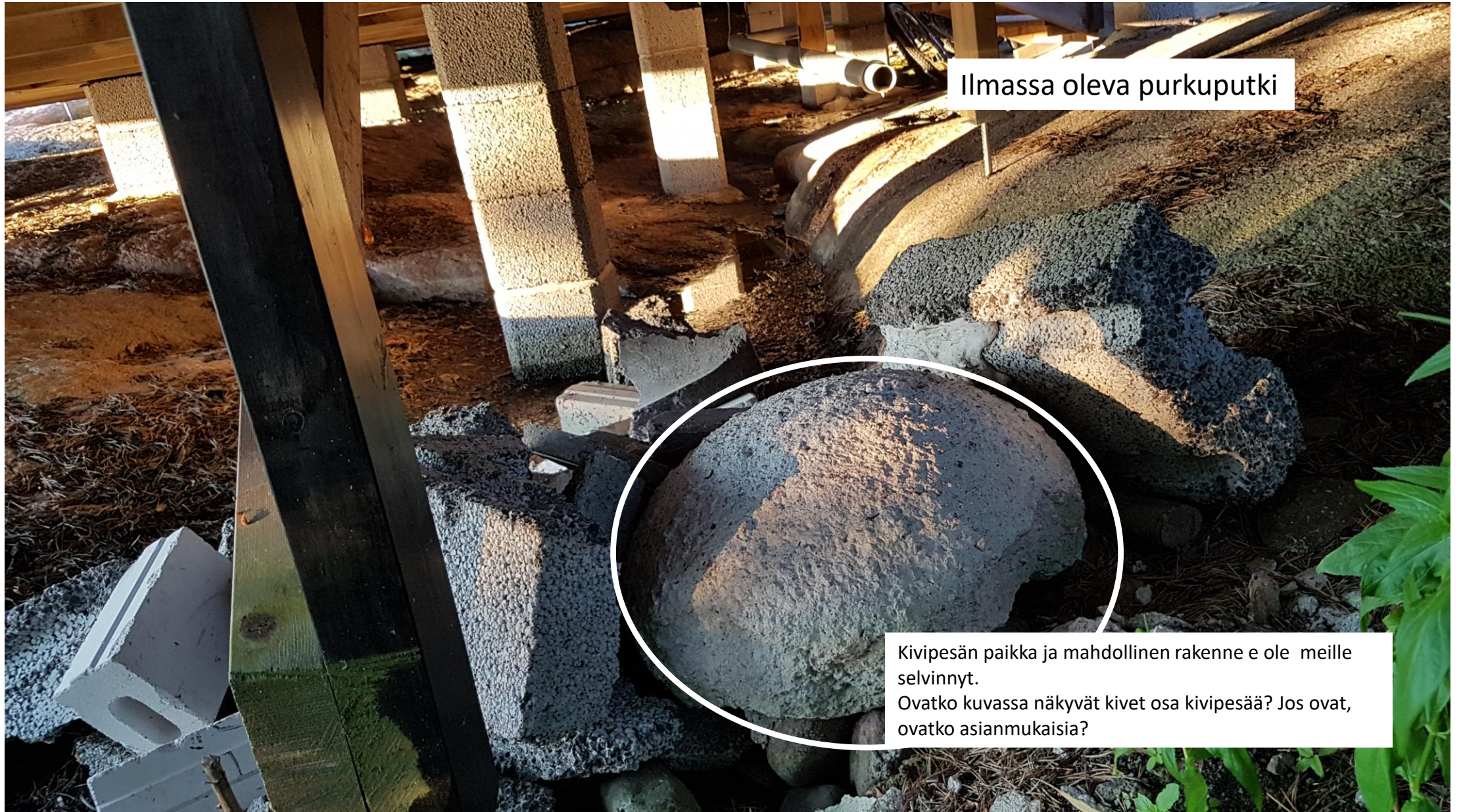
Kuva 2: Puhdistettujen jätevesien purkupuut
