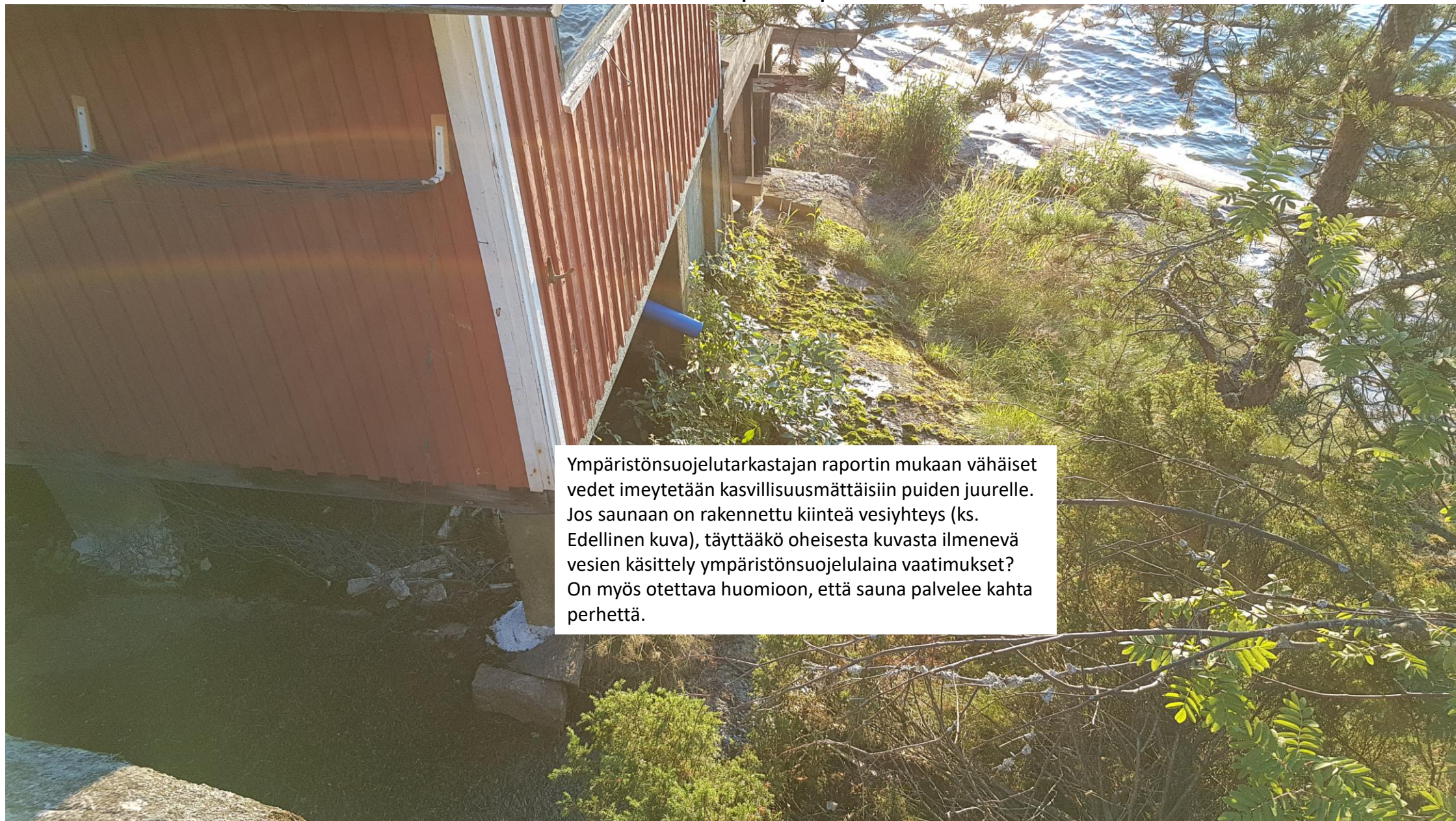
Kuva 5: Saunan harmaaavesien poistoputki
