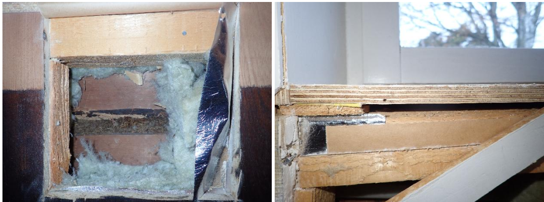
Kuvat 25 ja 26. Vanha hirsikuloseinä on lisäeristetty mineraalivillalla. Ilmansulkupaperia ei ole liitetty tiiviisti ikkunapenkkien kohdilta (R14 ja R13).
