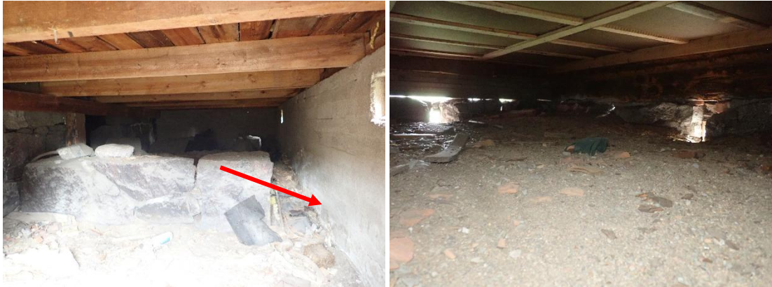
Kuvat 7 ja 8. Rakennuksen ryömintätilan tuuletus tapahtuu sokkelin aukkojen kautta. Kuistin betonisokkelin alaosassa havaittiin paikallisesti kalkkihärmää vanhan portaikon edustalla.
