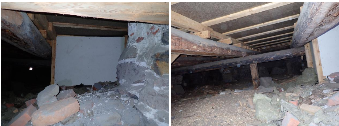
Kuvat 11 ja 12. Ryömintätilassa kulkevien viemäriputkien läpiviennit on koteloitu eikä niitä päästy havainnoimaan tarkemmin.
