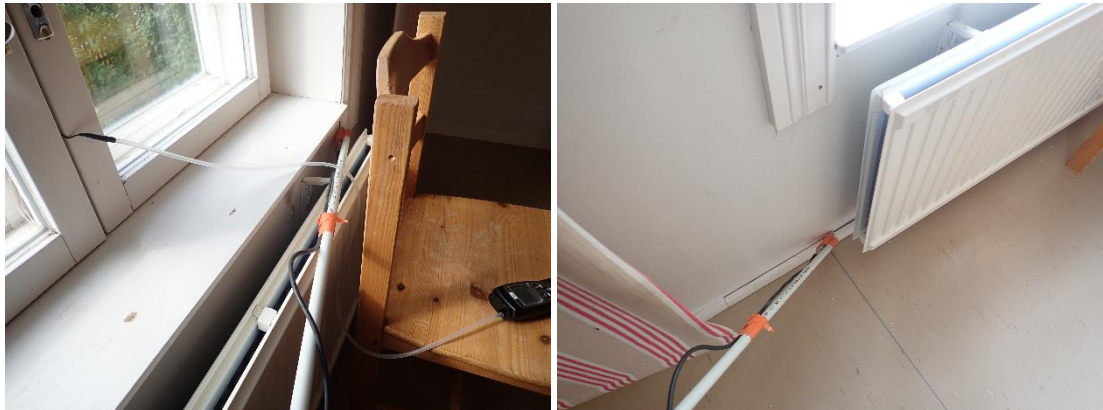
Kuvat 23 ja 24. Ulkoseinien liittymissä havaittiin vuotoilmavirtoja alapohjan merkkiairinekokeen yhteydessä.
