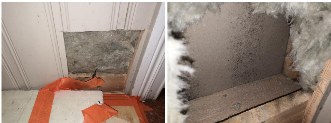
Kuvat 41 ja 42. Wc-tilojen väliseinissä havaittiin merkkejä ilmavuodoista ja mikrobikasvuun viittaavaa tummentumaa.
