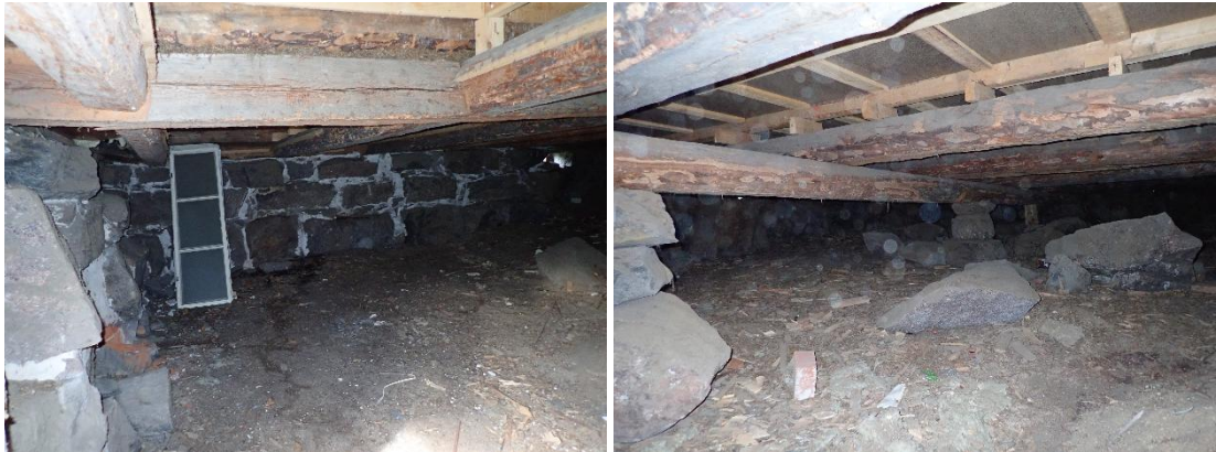
Kuvat 9 ja 10. Ryömintätilan maapohjalla havaittiin paikallisesti merkkejä pintavesien virtauksesta ja orgaanista ainesta.
