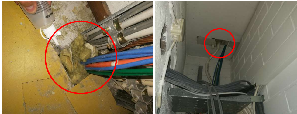
Kuvat 1-2. Sähkökaapissa havaittiin epätiivitä läpivientejä.
