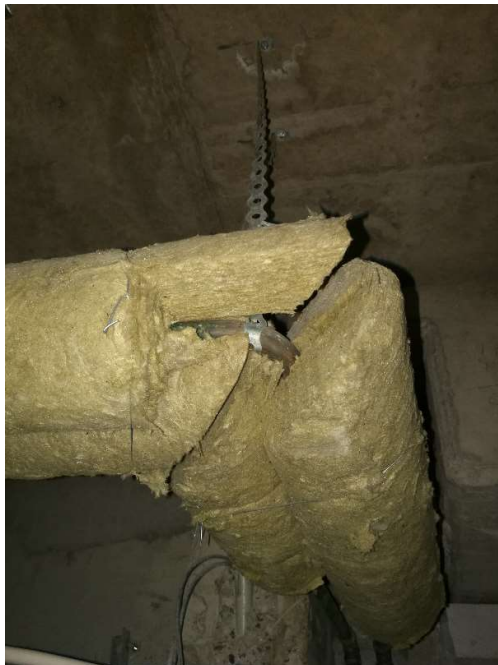
Kuva 3. Käytävällä alakaton päällä on pinnoittamalla villalla eristettyjä vesi- ja lämpöjohtoja.
