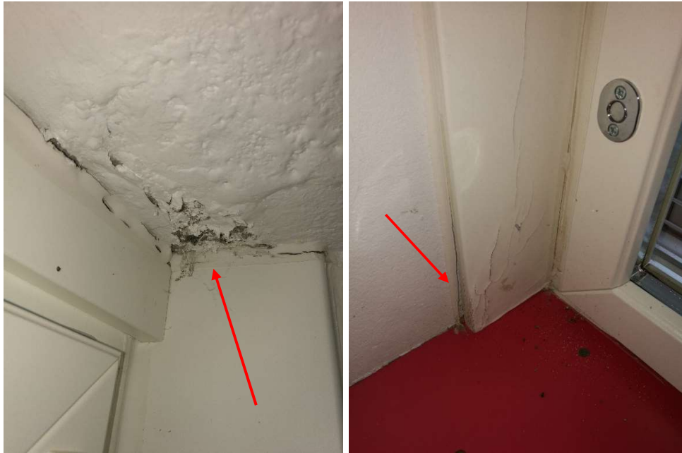
Kuvat 4-5. Ikkunasyvennyksien yläosissa havaittiin maalin kupruilua ja ikkunapielien levyrakenteissa havaittiin kosteusvaurioita.
