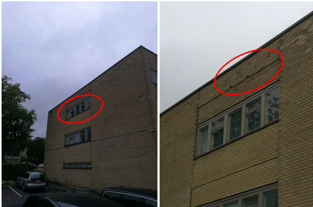
Kuvat 6-7. Kaupungintalon puoleisien ikkunasyvennyksien pielissä havaittiin viitteitä kosteusvaurioista (ikkunat ympyröity kuvassa 6). Päätyseinässä havaittiin runsaasti (lohjenneita tiiliä kuva 7).
